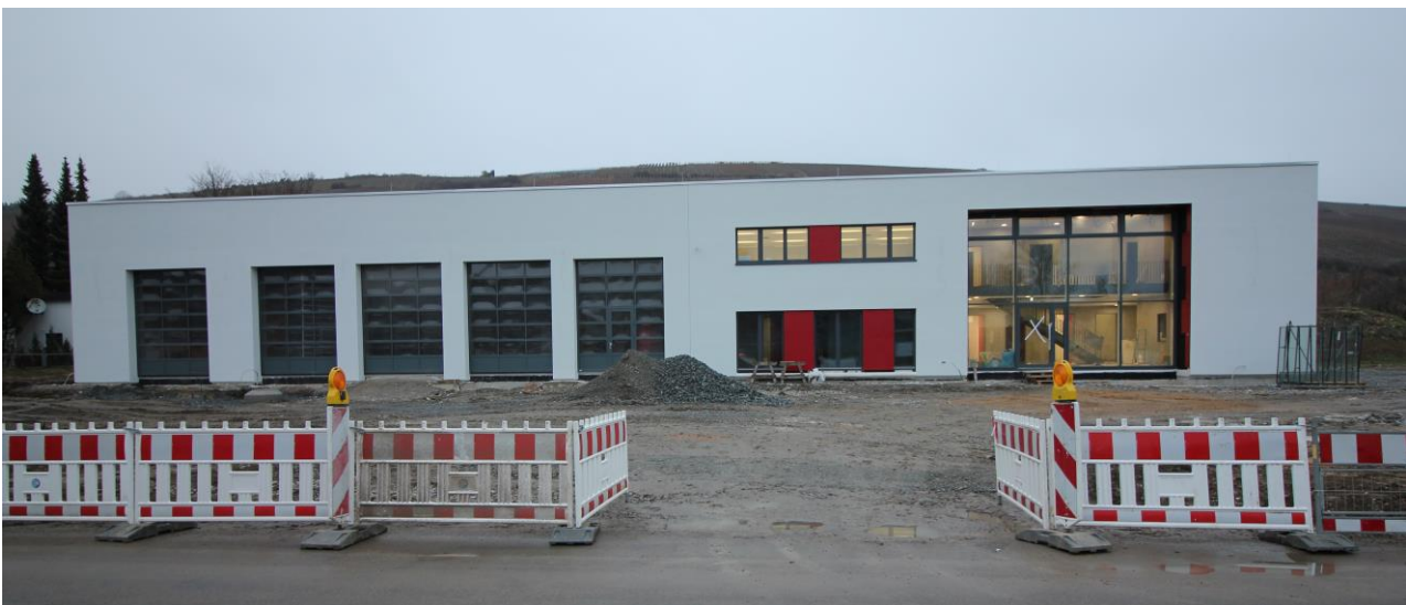
Der Neubau im Unteren Wasen ist bald bezugsfertig. Die Arbeiten an der Außenanlage sind angelaufen.
